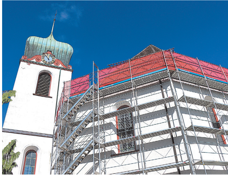
Am stärksten beschädigt ist die Südostecke der Kirche auf der Seite des Kirchgemeindehauses Arche.
